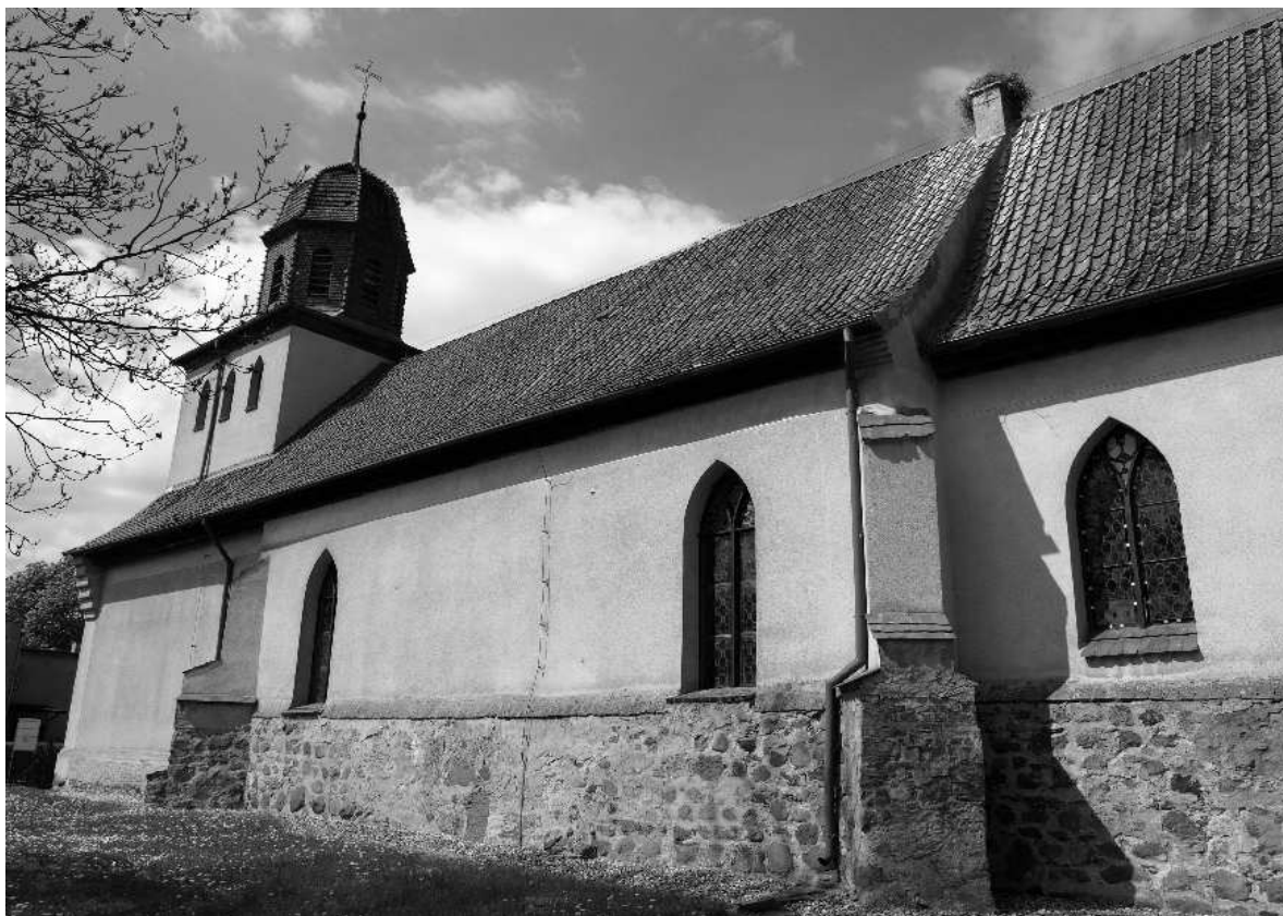
Zły stan techniczny dachu kościoła w Obrzyńowie.
